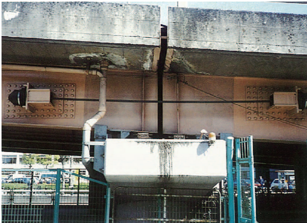
主桁間 PC 鋼材式落橋防止装置
